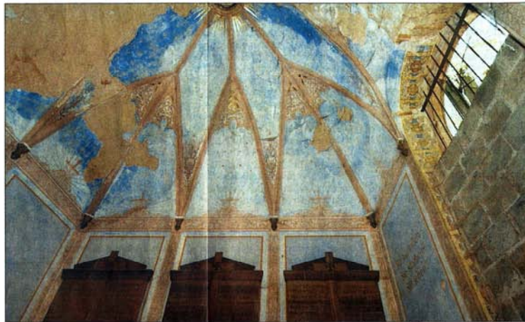
Die Malerei im Werner-Mausoleum ist stark angegriffen. Der Förderverein „Altstadt Hainichen“ möchte die Sanierung des Denkmals in seine Hände nehmen. –FOTOS: FALK BERNHARDT
